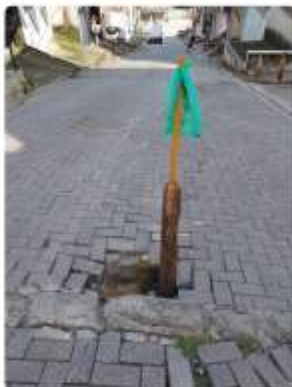
Vazamento com afundamento
