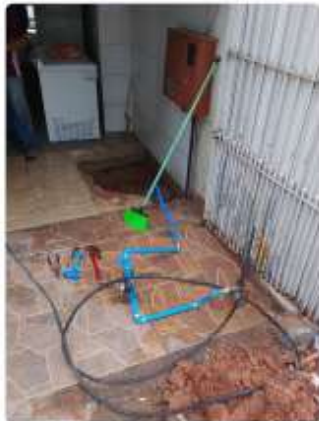
vazamento no ramal
